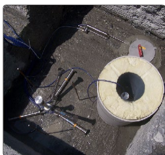
♦ Nid d'instruments dans le corps du barrage
