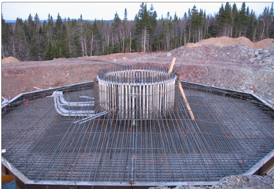
Instrumentation de la fondation, de l'armature, des ancrages et de la tour
