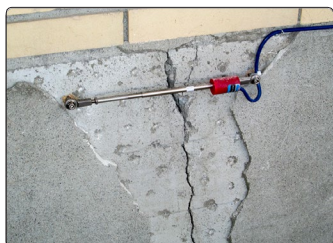
◆ Fissuromètre Geokon modèle 4420 installé sur la fondation
