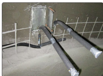
◆ Mesure de contrainte radiale et tangentielle au contact du sol et du revêtement de béton projeté avec des cellules de pression totale 4850 de Geokon
